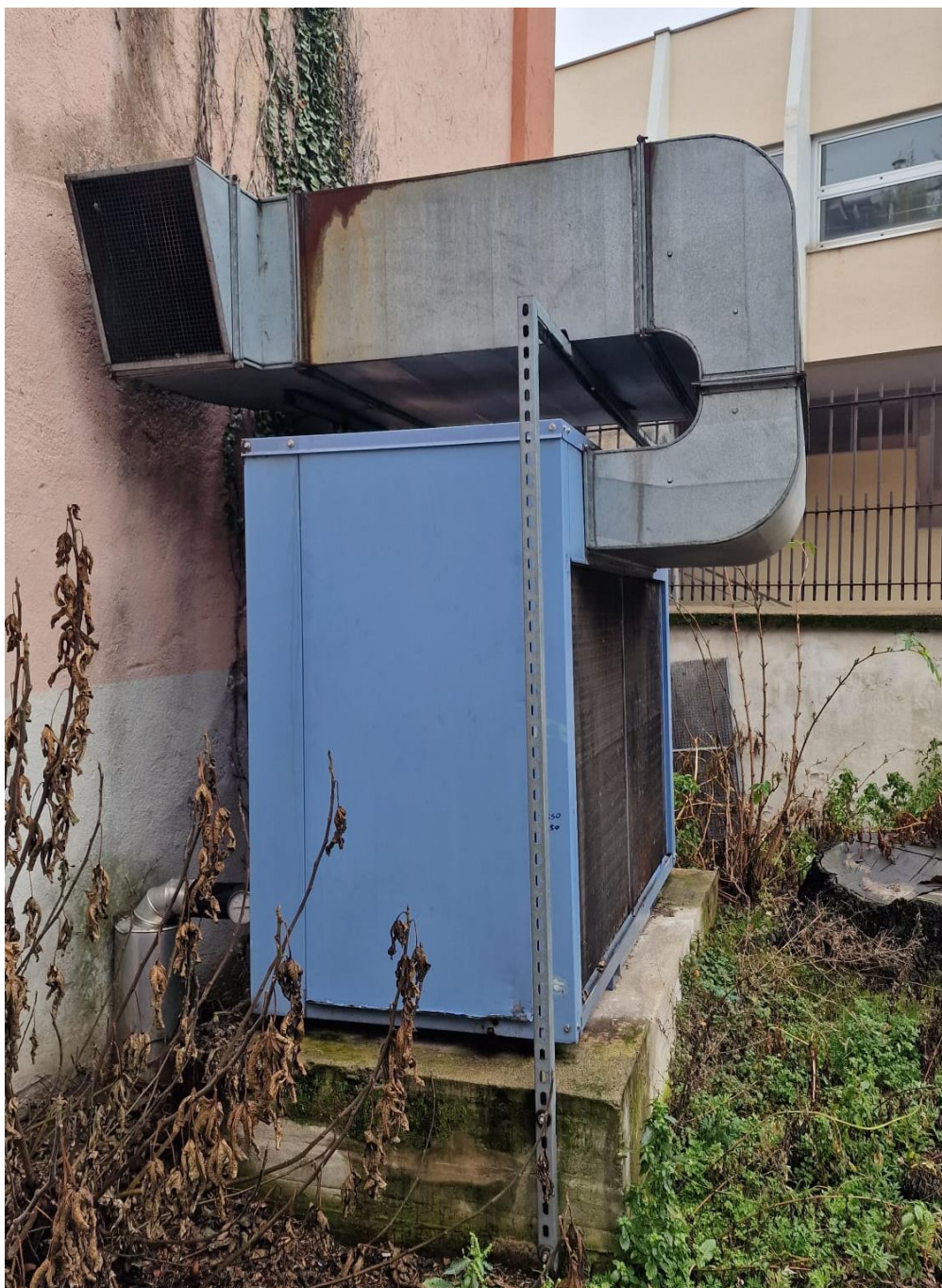
Gruppo Frigorifero BLUE BOX da sostituire
